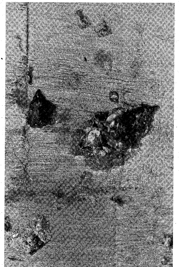
Eksempel III. Betongulv nedbrudt på grund af urenheder i tilslaget.
