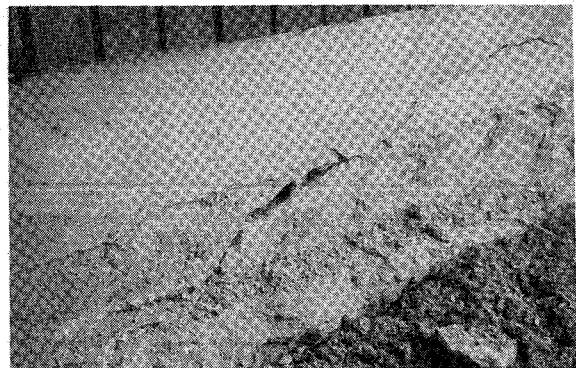
42 og 43 Bygningen revner på grund af gennembrudt fundamentsbjælke.
